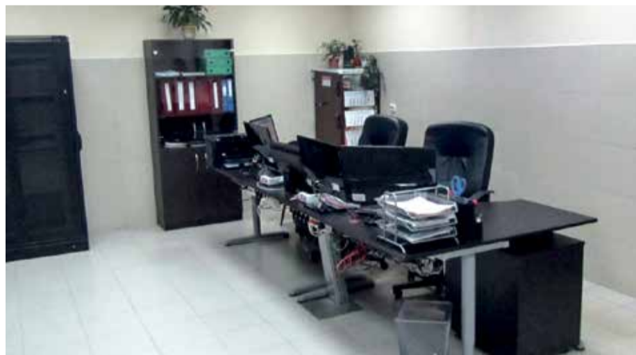
Пульт зд. 05, 04, 05б после реконструкции
